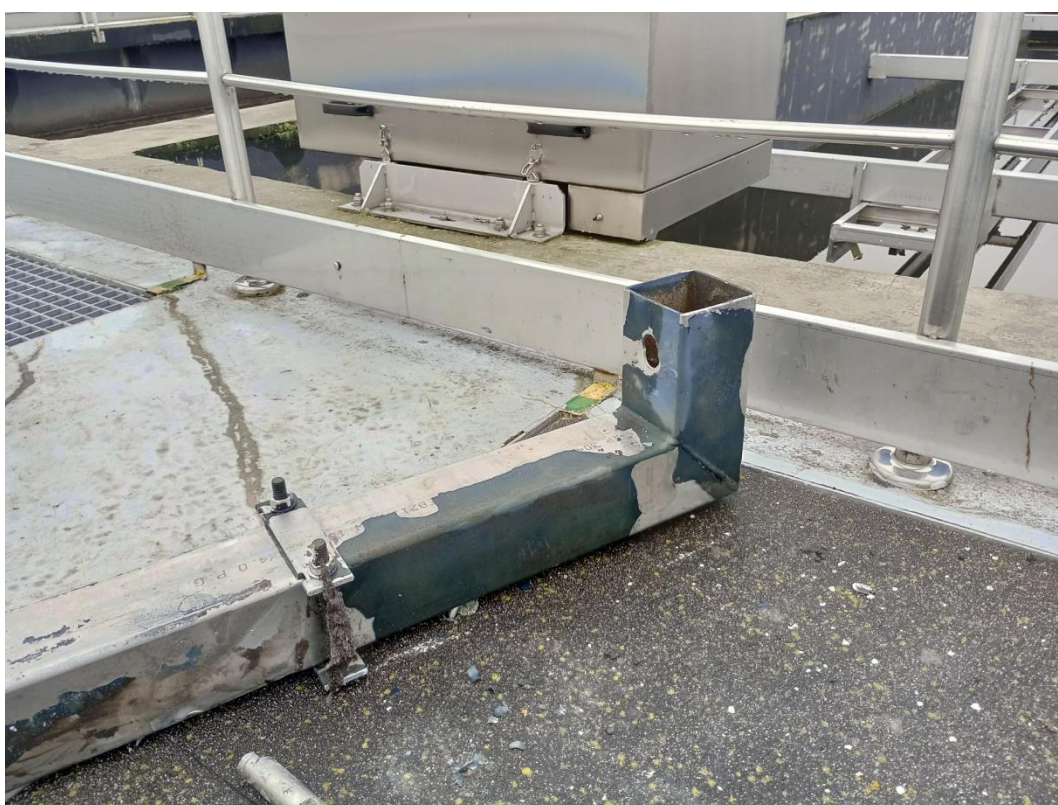
Uszkodzone mieszadło Flygt 4650.412 przed regeneracją wraz z innymi uszkodzonymi elementami konstrukcji.
