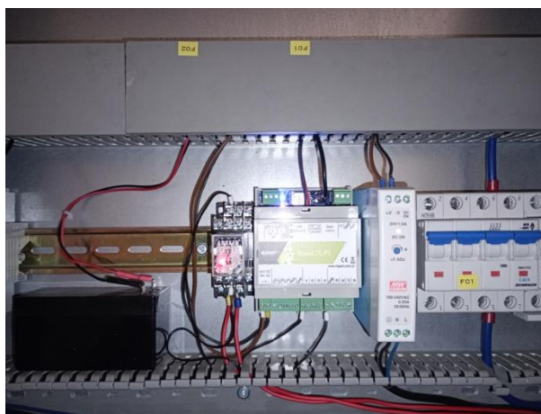
Moduł GSM monitorujący poprawność pracy układu zasilania pomp.
