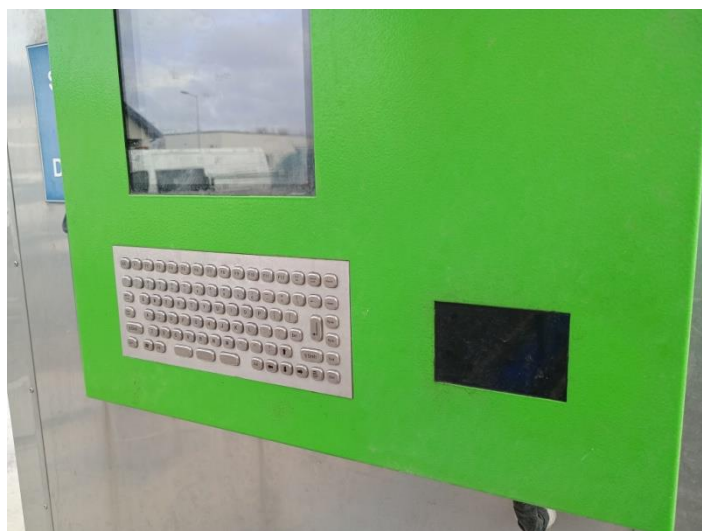
Wymieniony panel klawiatury przy systemie przyjmowania ścieków dowożonych „Ścieki Polskie”.
