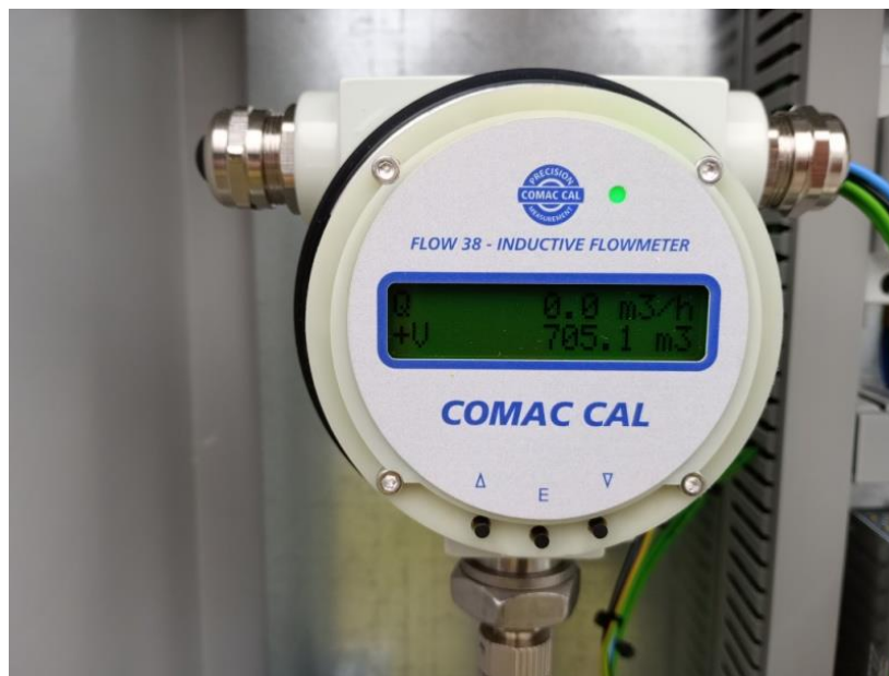
Licznik przepływomierza zamontowanego na kolektorze ścieków dopływających z sieci kanalizacyjnej Koziegłówki.
