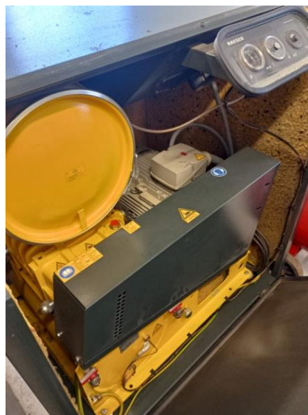
Wnętrze jednej z dmuchaw z widocznym silnikiem, filtrem oraz układem olejowym.
