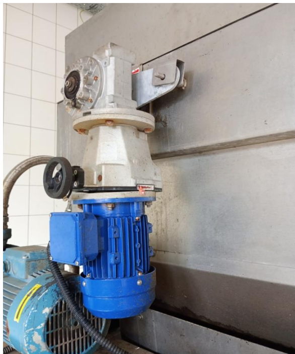
Silnik lewego zagęszczacza osadu prasy taśmowej MONOBELT podczas pracy.
