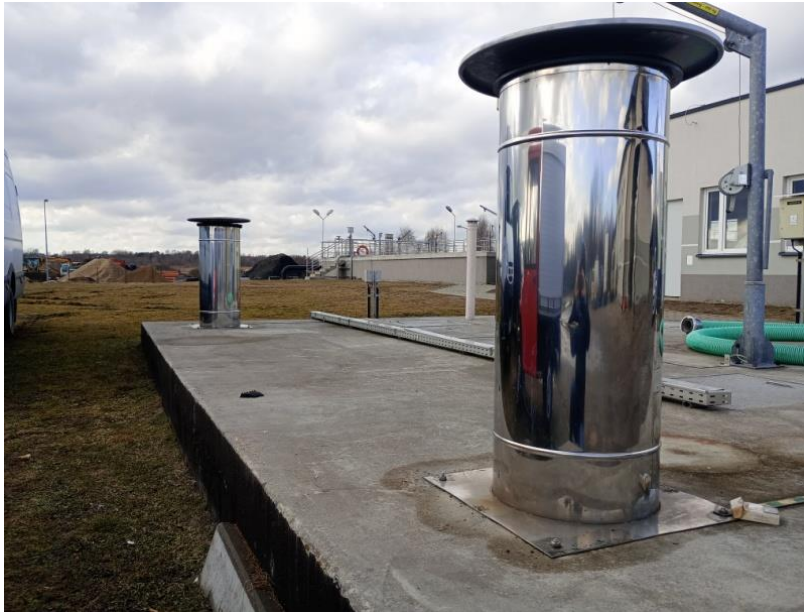
Biofiltry kominkowe na jednej z pompowni zlokalizowanych na terenie oczyszczalni ścieków.
