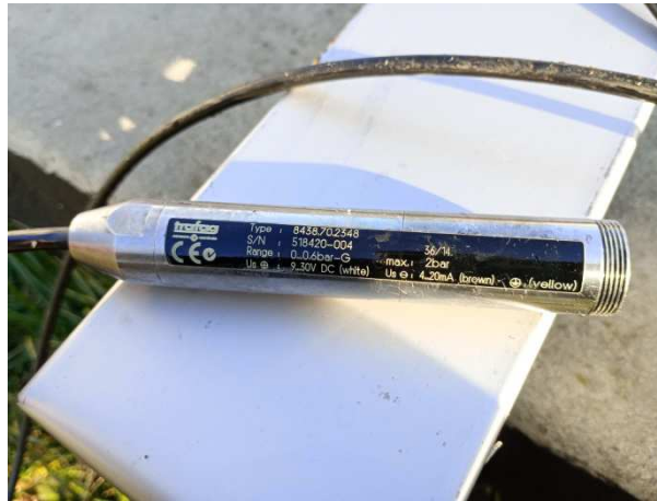
Zdj. Uszkodzona sonda hydrostatyczna z pompowni głównej ścieków z wadliwym sensorem.
