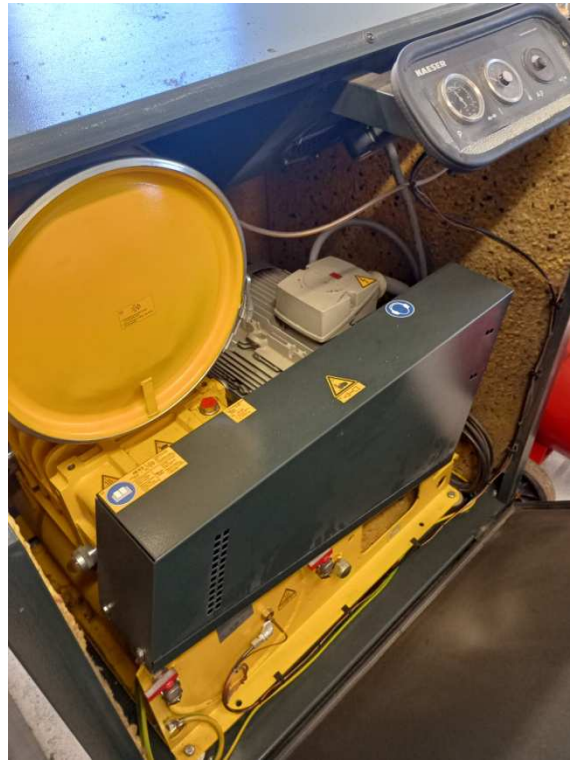
Zdj. Wnętrze jednej z dmuchaw z widocznym silnikiem, filtrem oraz układem olejowym.
