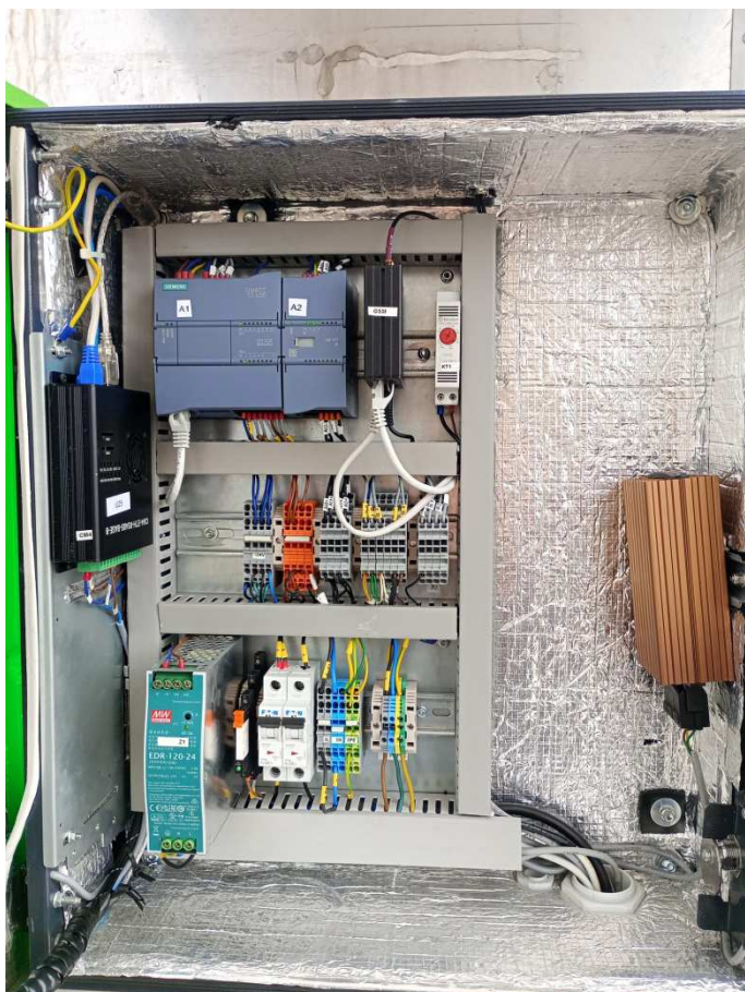
Zdj. Wnętrze szafy sterującej systemem zrzutu ścieków dowożonych „Ścieki Polskie” po modernizacji.
