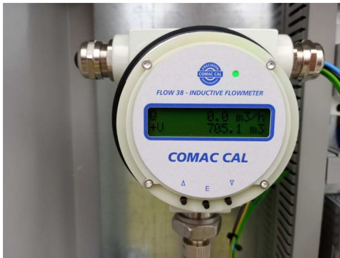
Zdj. Licznik przepływomierza zamontowanego na kolektorze ścieków dopływających z sieci kanalizacyjnej Koziegłówki.
