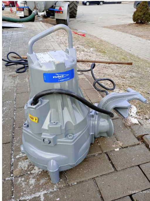
Zdj. Strumienica Flygt 3085.160-2480900 zamontowana w pompowni zlewnej.
