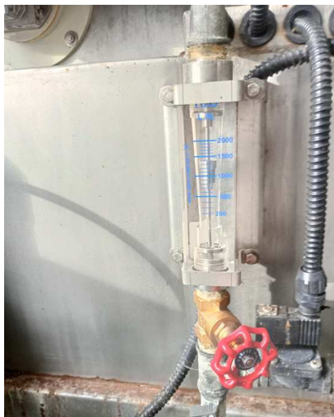
Zdj. Rotametr z zaworem kulowym do regulacji przepływu wody w stacji przygotowania polielektrolitu.
