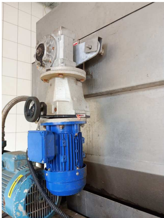
Zdj. Silnik lewego zagęszczacza osadu prasy taśmwej MONOBELT podczas pracy.
