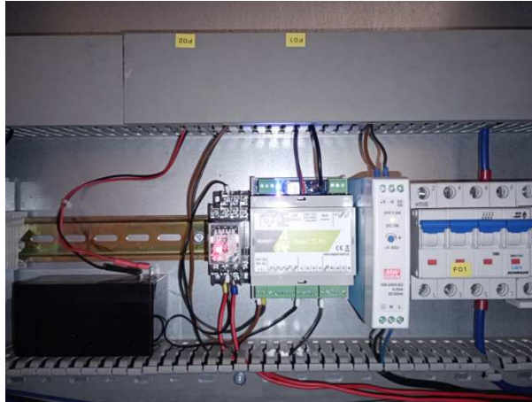
Zdj. Moduł GSM monitorujący poprawność pracy układu zasilania pomp.
