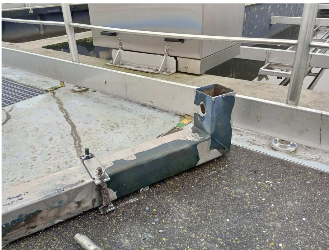
Zdj. Uszkodzone mieszadło Flygt 4650.412 przed regeneracją wraz z innymi uszkodzonymi elementami konstrukcji.
