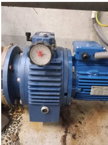
Zdj. Wymieniony wariator przy pompie osadu nadmiernego służący do regulacji dopływu osadu na zagęszczacze prasy taśmowej.
